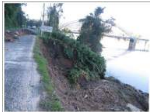
FIGURA 26: DESLIZAMENTO DE MASSA NA SAÍDA PARA A BR-153 (DONA MERCEDES)
