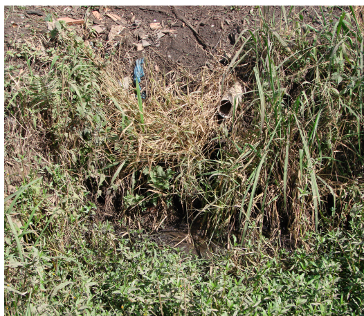
Figura 28 Despejo de Esgoto na Vala de Drenagem Pluvial no Bairro Sagrada Família
