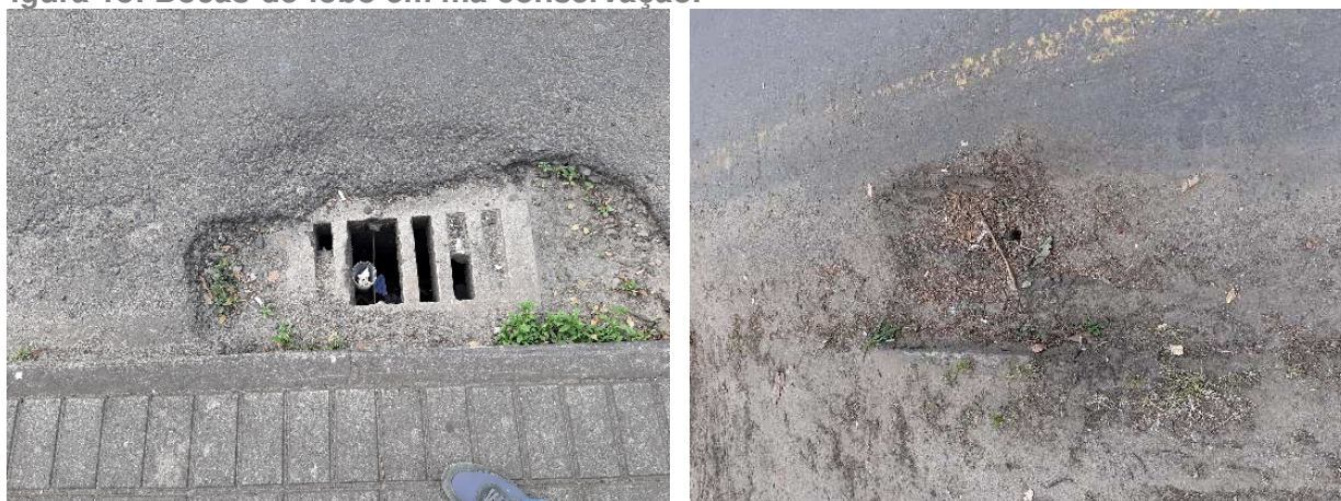
Figura 18: Bocas-de-lobo em má conservação.
