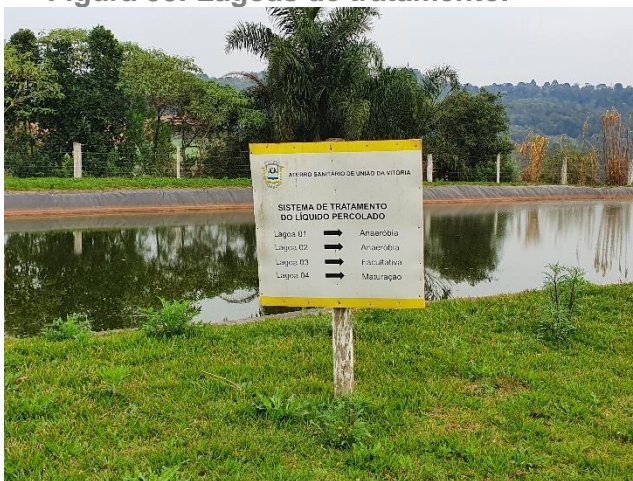
Figura 38: Lagoas de tratamento.
